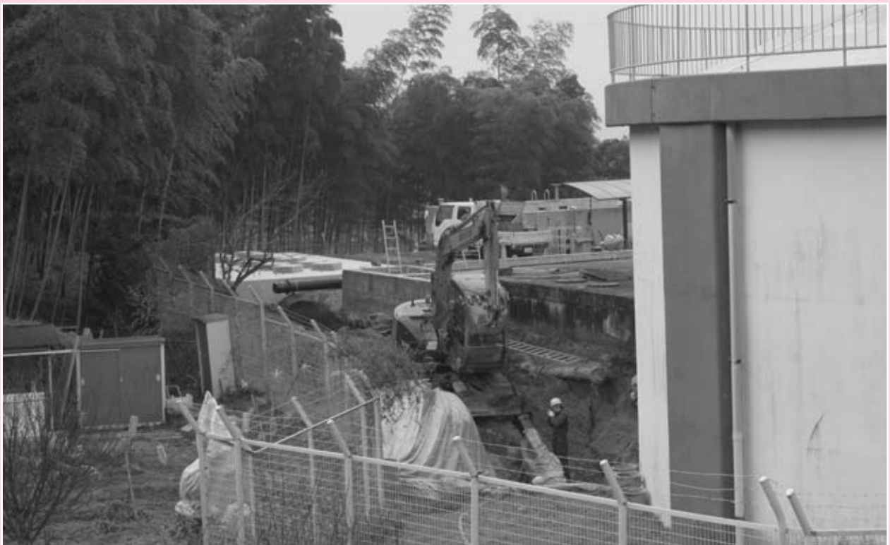
ろ過機更新が予定されている井手浄水場
