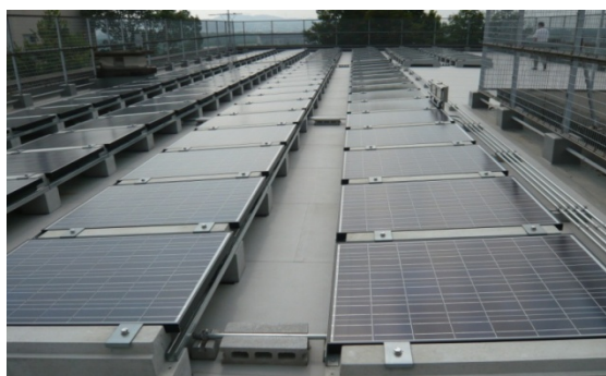
(多賀小学校屋上太陽光発電設備)
