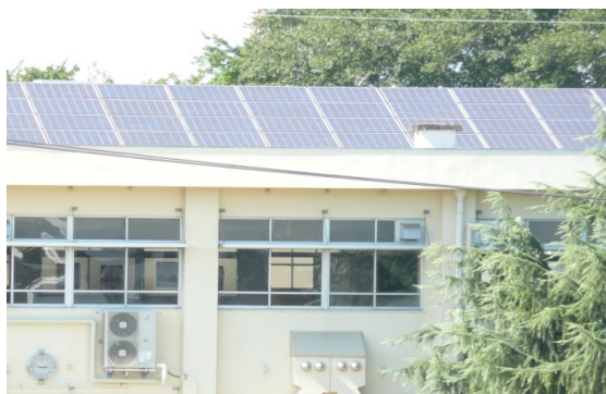
(泉ヶ丘中学校屋上太陽光発電設備外観)
