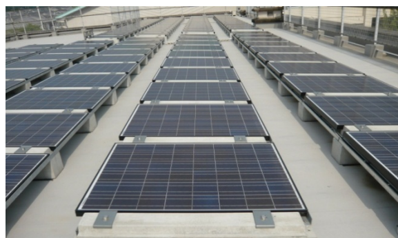
(井手小学校屋上太陽光発電設備)
