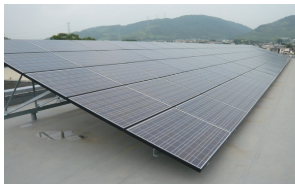
(泉ヶ丘中学校屋上太陽光発電設備)
