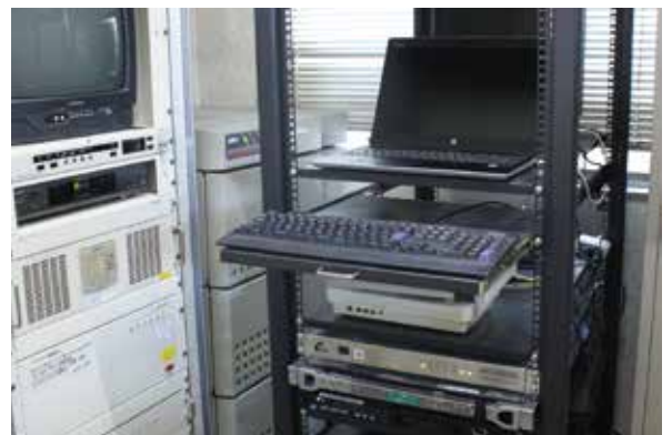
防災情報通信設備更新
