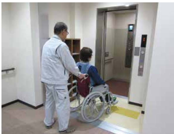
いづみ人権交流センターのエレベーター
