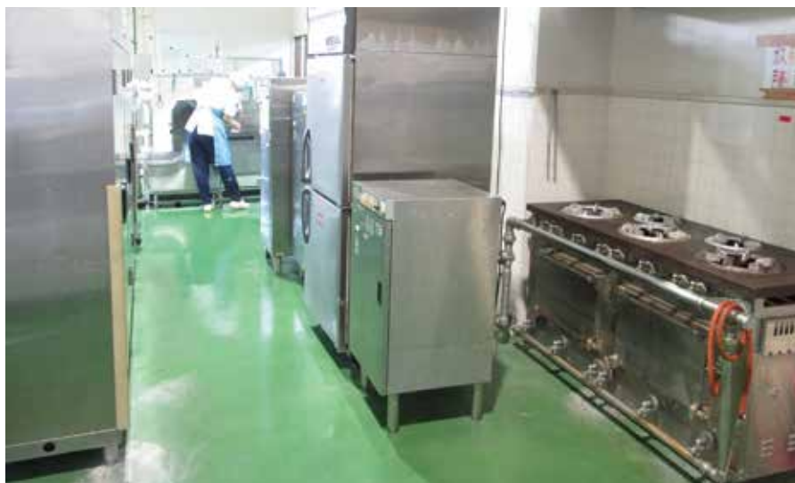
学校給食センター調理室
