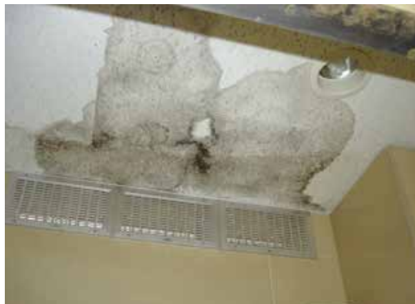
山城多賀駅前トイレの天井
