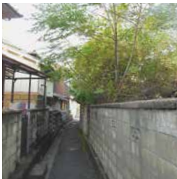
町道にはみ出した樹木
