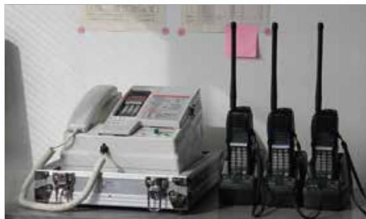
新設された防災無線
