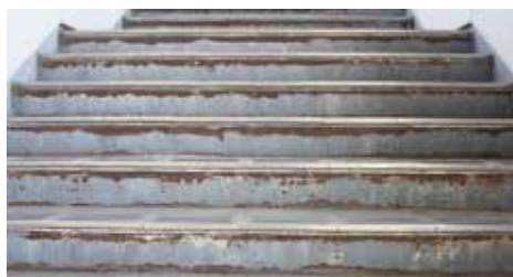
老朽化が進んだ山城多賀駅の構内階段
