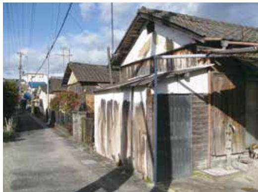
老朽化が進む町営住宅
