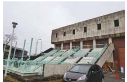
合敷ポンプ場
