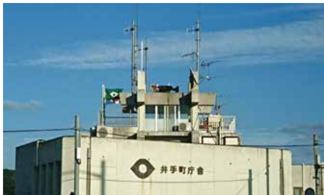
移動系の防災無線基地局
