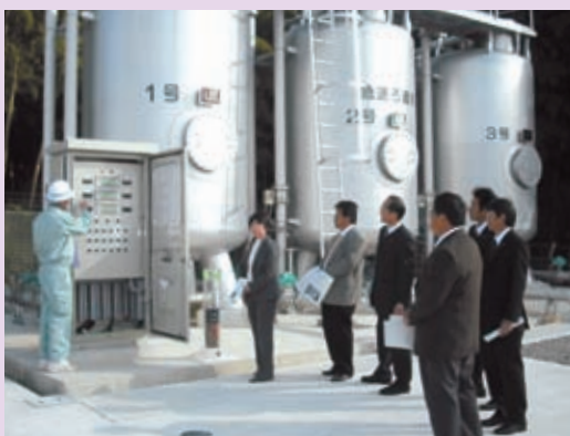
完成したろ過機
