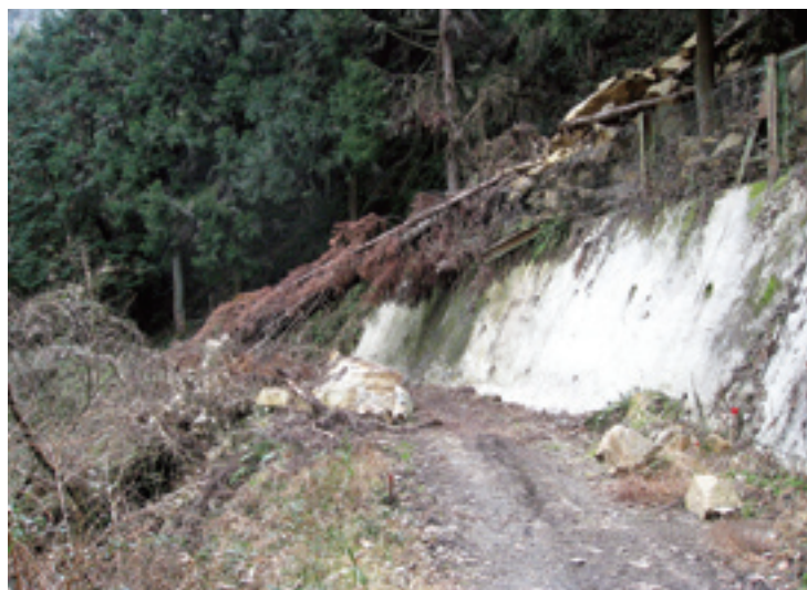
復旧が待たれる町道35号線
