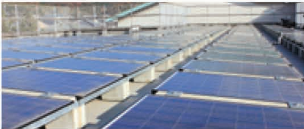
多賀小の太陽光発電パネル
