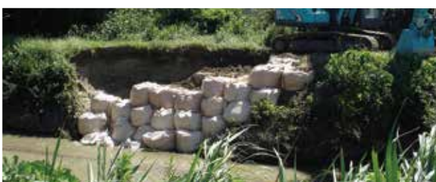
9月16日に被災した青谷川(天井川)
