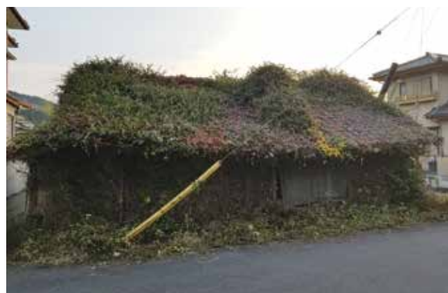
老朽化した空き家
