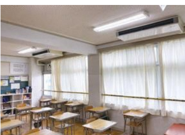
感染症対策として整備される空調設備
