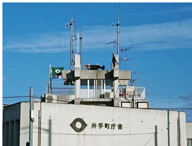
移動系防災行政無線の基地局
