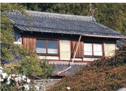
雨樋が外されるなど、深刻化する猿被害
