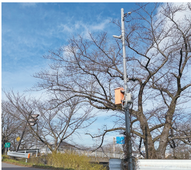
玉川堤防付近に設置されている街灯
