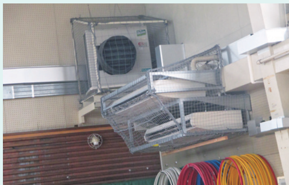
実際に設置されている空調設備
