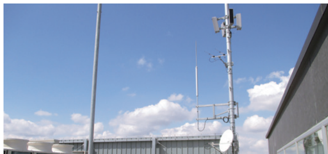
庁舎に整備された同報系行政防災無線
