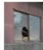
窓が割れた 管理不全空家
